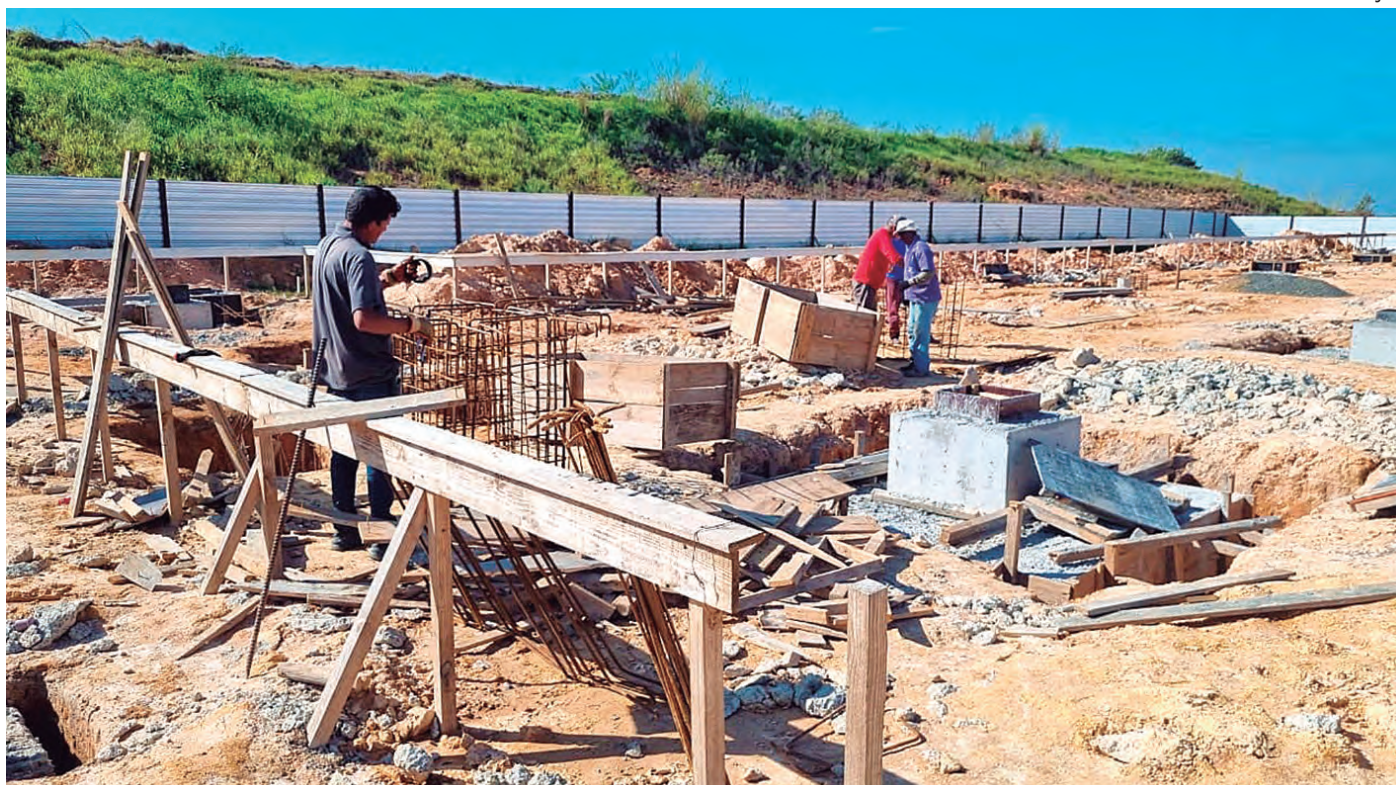
FORMANDO MÃO DE OBRA. Prosseguem as obras do novo Centro Municipal de Iniciação Profissional Roberto Moreau (Cemip/Senai). A construção e concretagem das sapatas (fundações) estão em fase final. Nesta semana, as equipes também aterraram e nivelaram o terreno para dar início, nos próximos dias, à construção do piso. O novo prédio está sendo construído em Altos do Jequitibá, próximo ao Estádio Municipal Ernesto Rocco. Com cursos 100% gratuitos e capacidade para atender até 4.000 alunos por ano, o novo prédio permitirá ampliar a oferta de cursos profissionalizantes em até três vezes.
