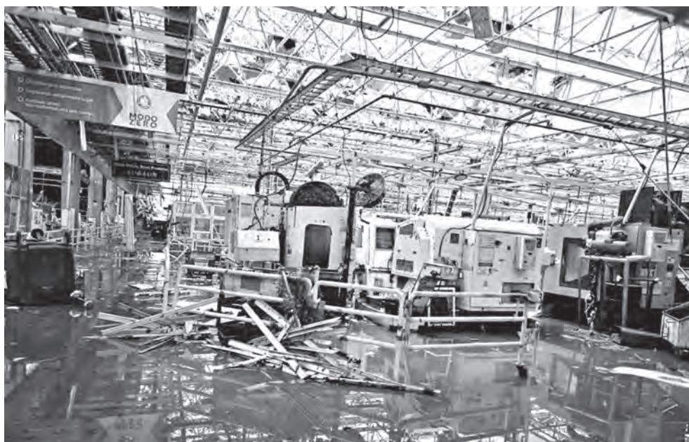
ESTRUTURA DESTRUÍDA. O maior estrago foi causado pela esteira rolante que transporta ferramentas; ela caiu sobre a linha de produção, danificando o maquinário e inviabilizando a produção a médio prazo
