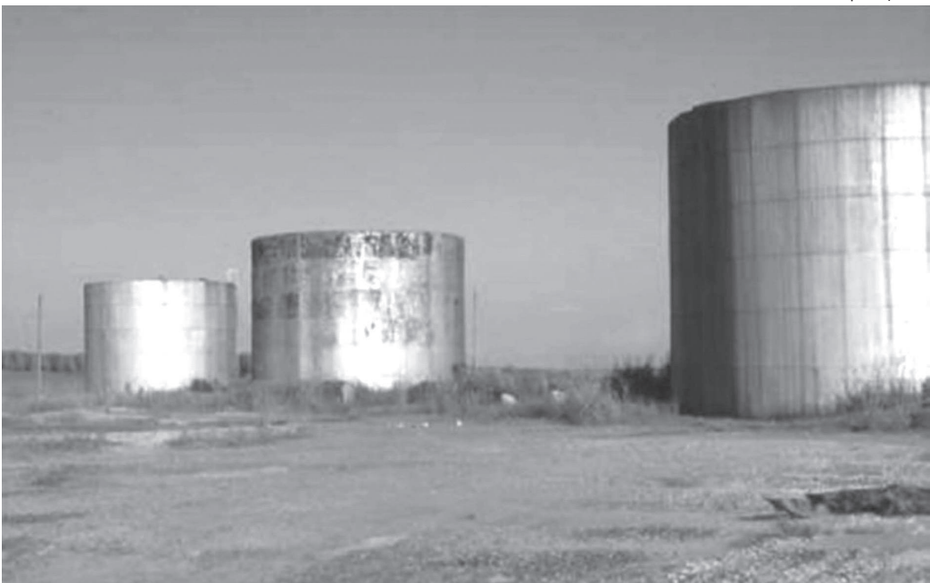
IRRESPONSÁVEL. A USA Chemicals mantinha produtos altamente perigosos nestes tanques, sem qualquer estrutura de contenção para impedir que se espalhassem
