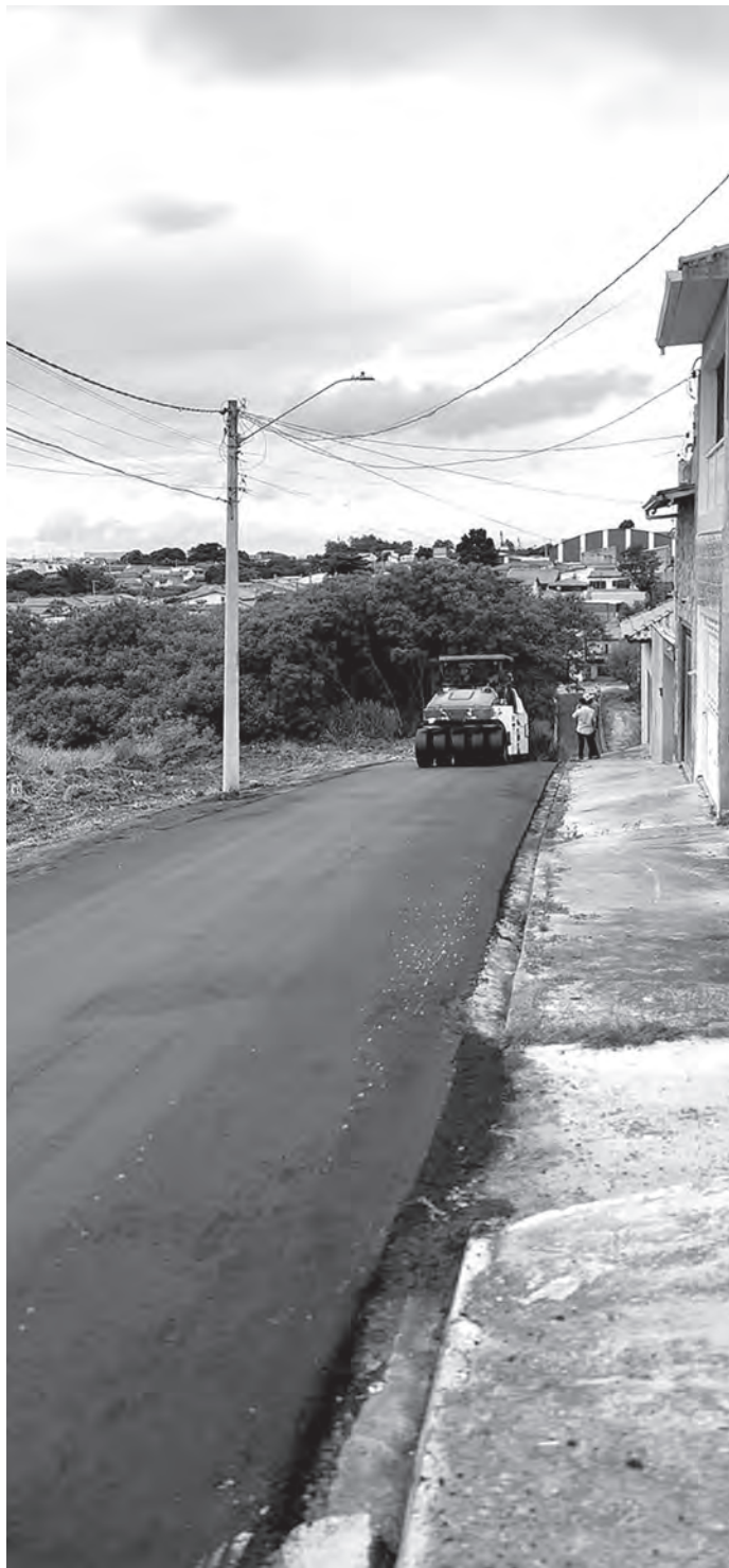
NOVO ACESSO. Moradores e motoristas terão mais segurança com o asfaltamento e infraestrutura da rua
