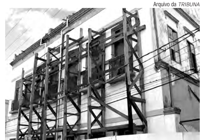
AMEAÇADO. Uma estrutura de madeira foi montada em 2019 para evitar que a fachada ruísse
